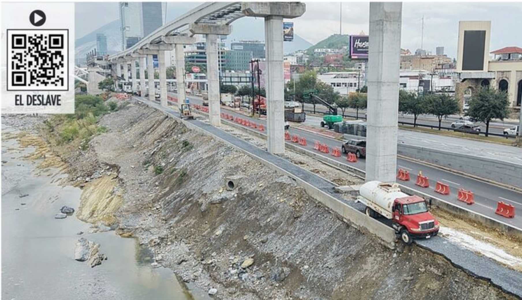
Las lluvias provocaron el deslave de un tramo del Parque Lineal, bajo la Línea 4 del Metro en Monterrey, donde una pipa quedó suspendida.
