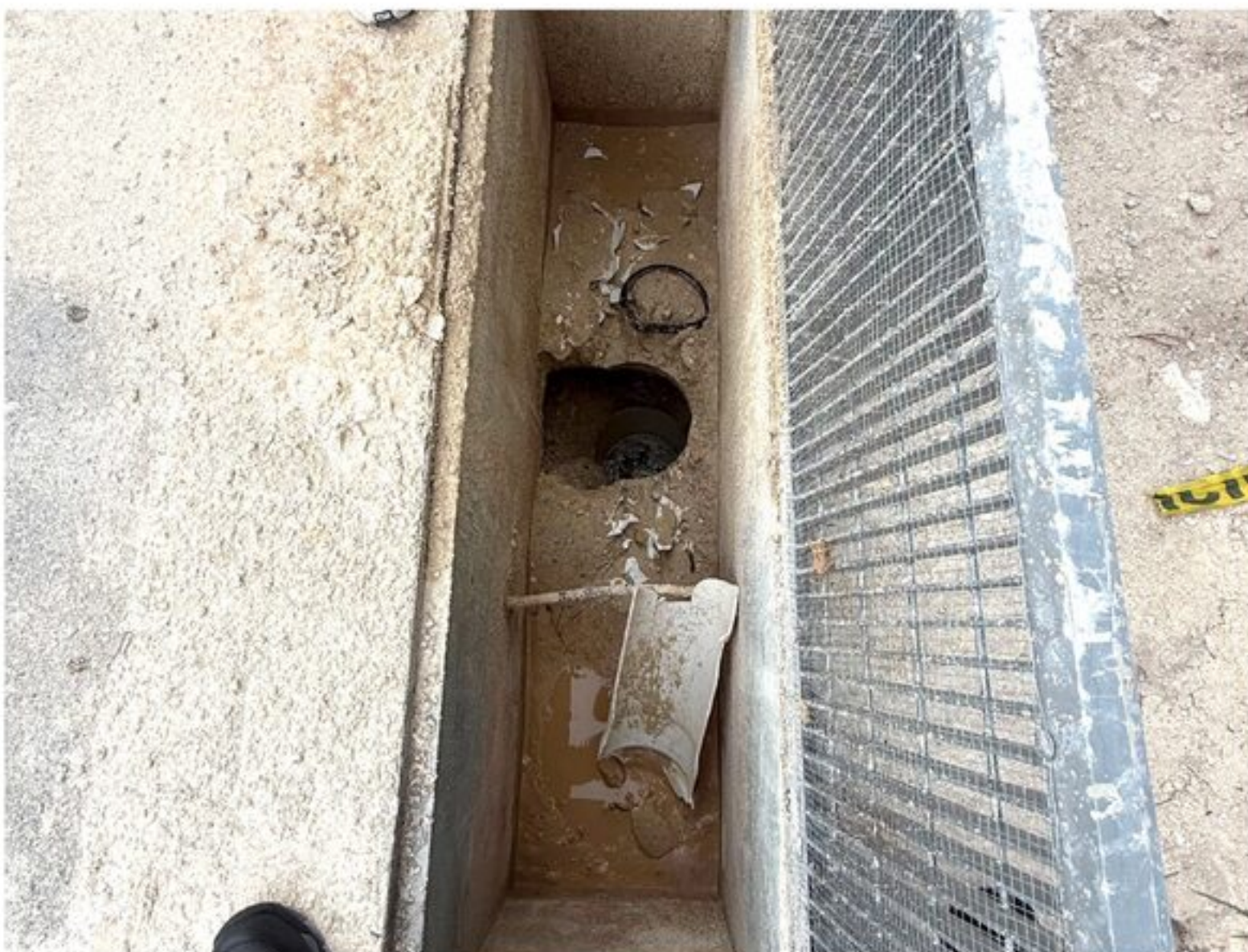
Fueron halladas tapas levantadas y tuberías quebradas recientemente colocadas.
