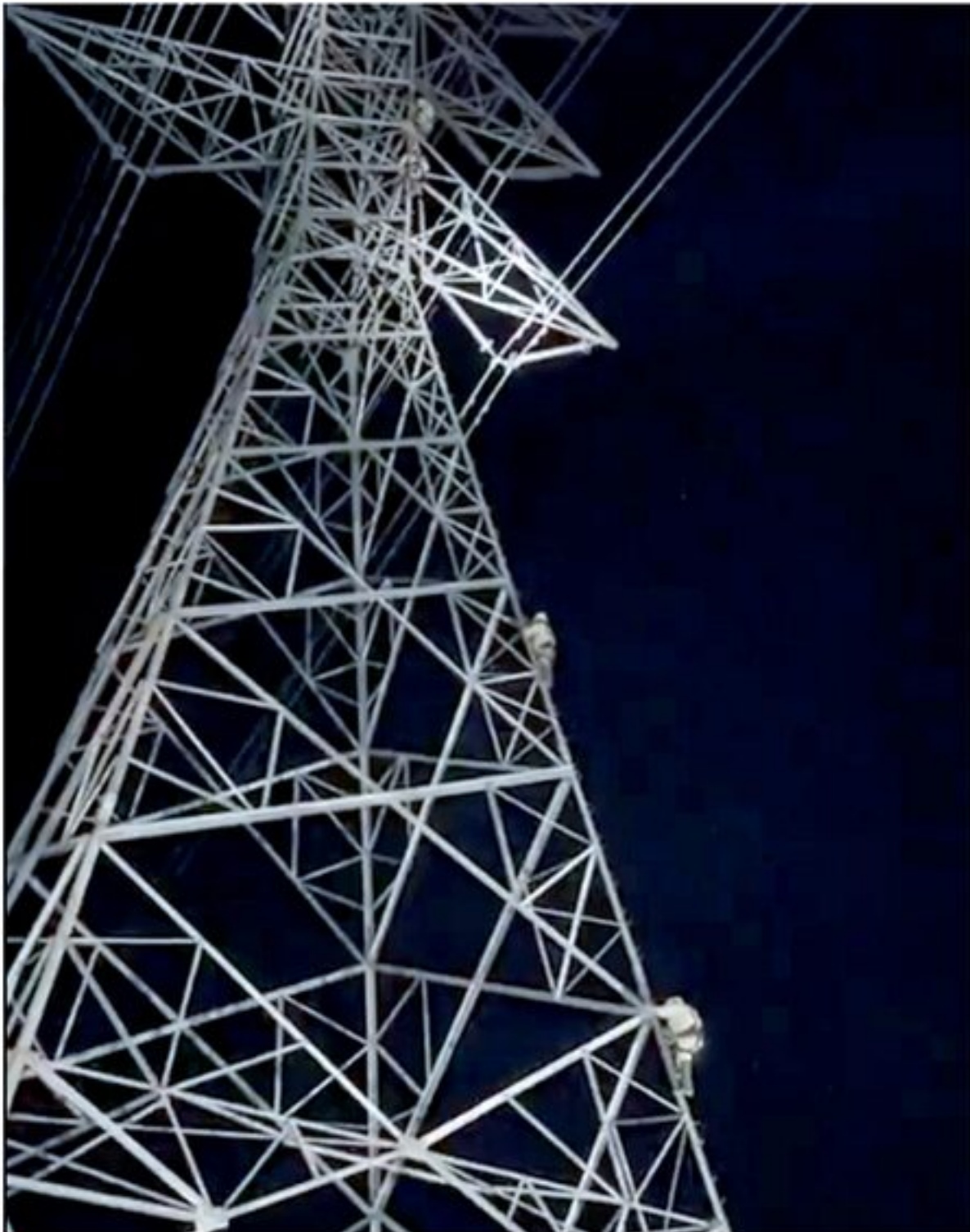
Torres de transmisión donde se encontraron afectaciones.
