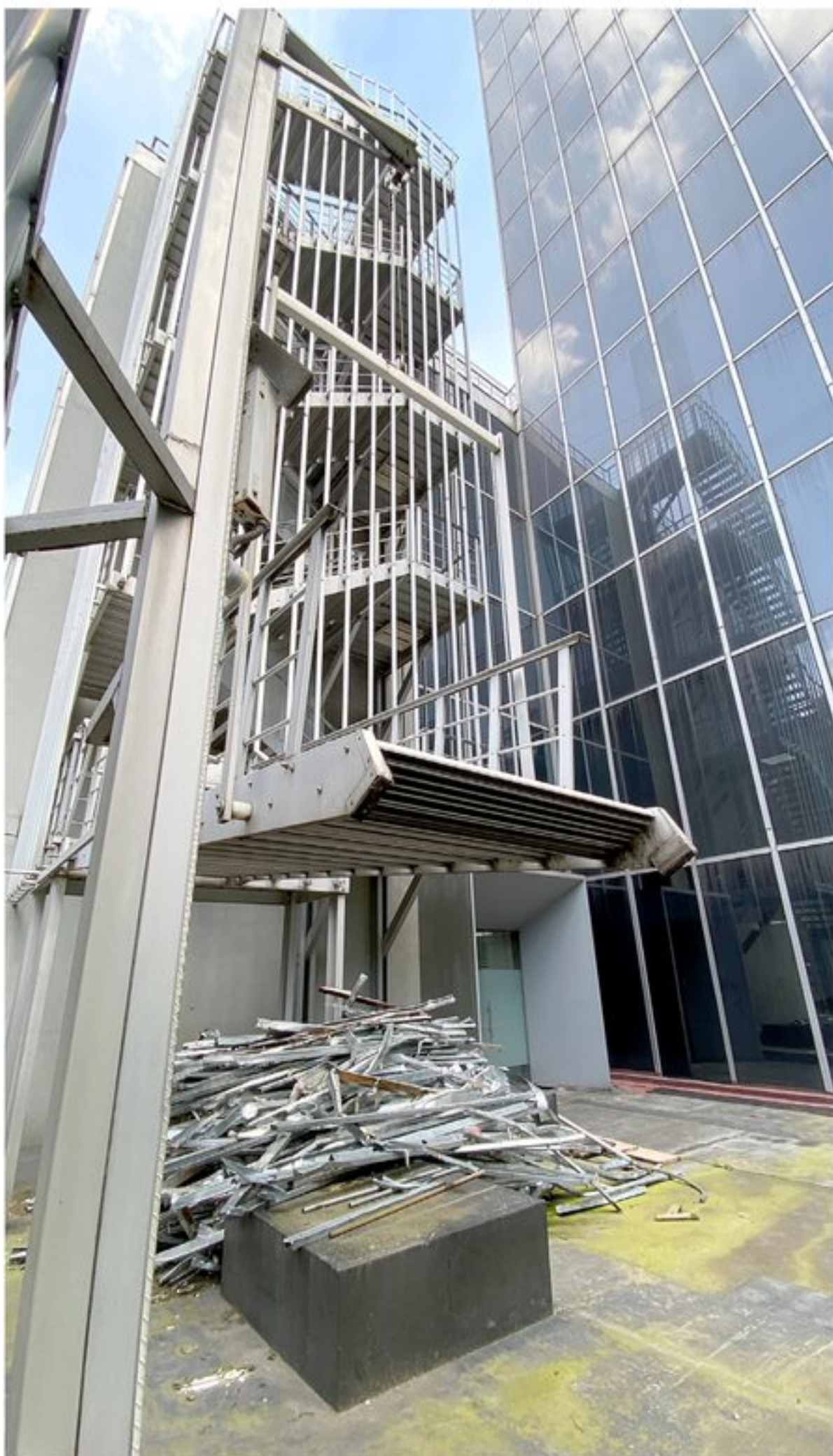
Para este año se asignaron 50 millones de pesos para el proyecto de reforzamiento estructural, pero a la fecha no se observan labores en los inmuebles.
