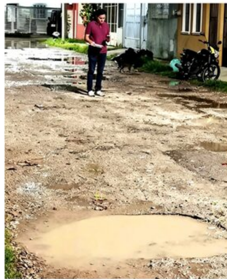
Habitantes de la colonia Amapola demandan desahucio de drenajes, atención a baches severos y hasta instalación de un paso peatonal.
