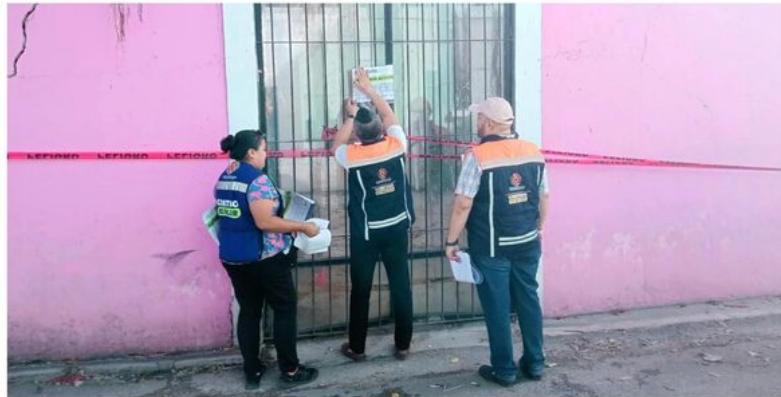
En el lugar funciona una tienda de ropa, pero se observan amplias grietas en las paredes, por lo que representa un peligro.
